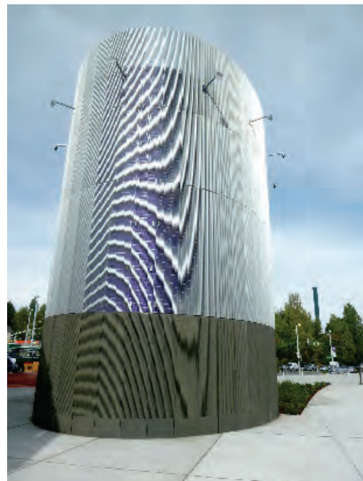
位於西雅圖UW車站的垂直通風口 Vertical ventilation at UW Station in Seattle
